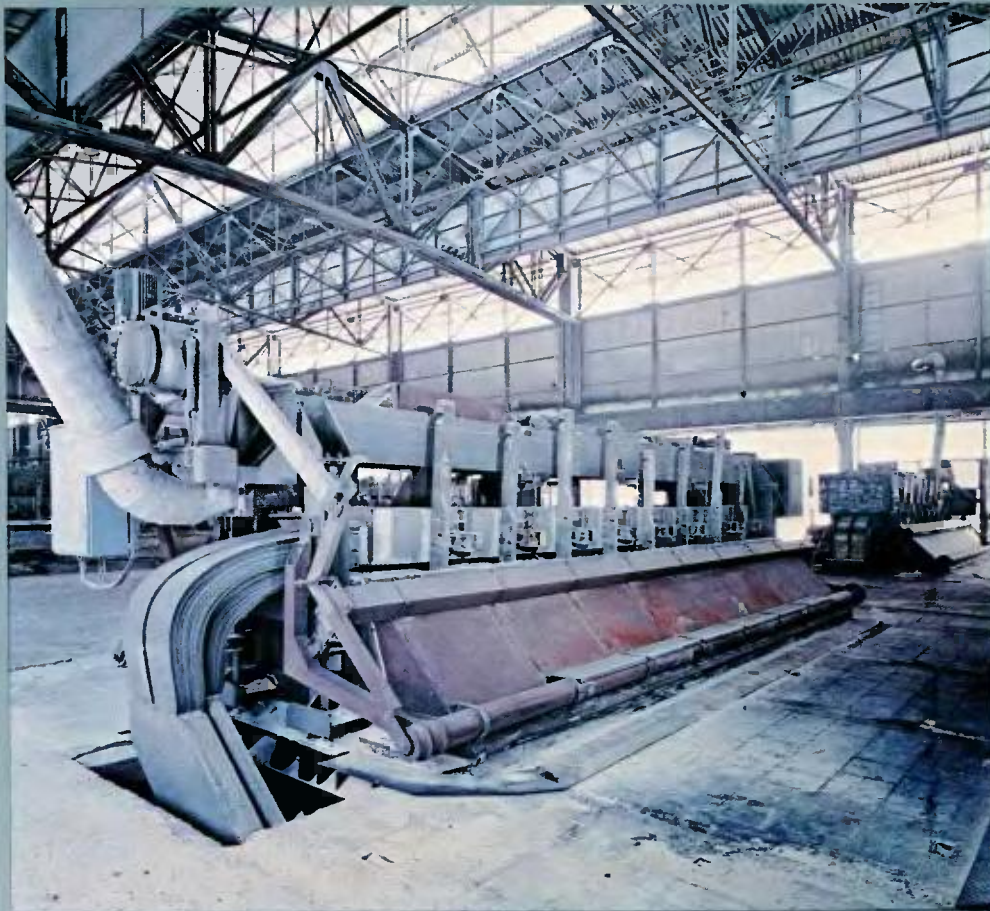
Καλυμένη λεκάνη Ήλεκτρολύσεως Cuve d'Electrolyse capotée
