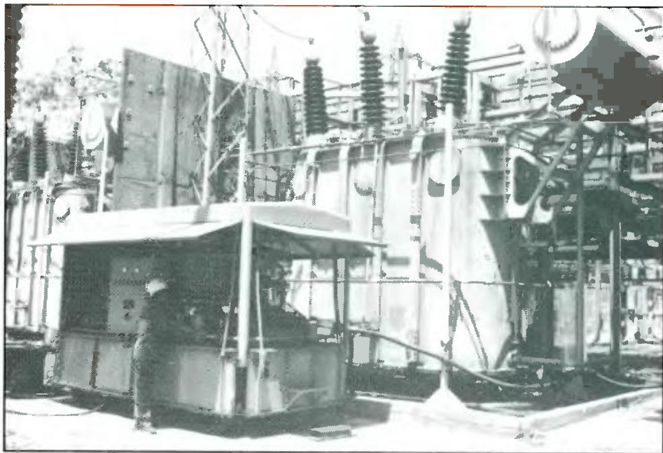
Ο κ. Δ. Μωυσίδης, υπομηχανικός της ΔΕΗ ενώ χειρίζεται την συσκευή καθαρισμού λαδιών στον μετασχηματιστή Νο 2
