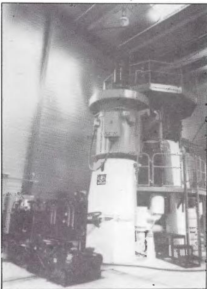
Η ΡΑC κατά τη φάση των δοκιμών από την κατασκευάστρια εταιρεία στη Γαλλία.
