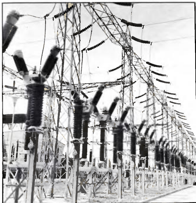
Εξώφυλλο: Συγκροτήματα ελαιοδιακοπών 150KV στον Υ.Σ.ΔΕΗ του Εργοστασίου μας.
