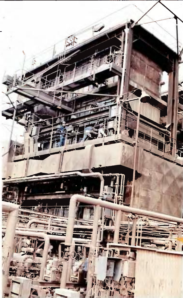
Γενική άποψη της εγκατάστασης του λέβητα MAN No 1, από την βόρεια πλευρά.
