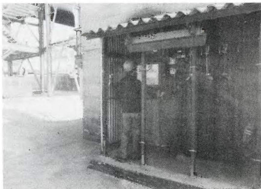
Ο σταθμός πυρανίχνευσης-πυροπροστασίας του Υποσταθμού διανομής 15 KV Τμήματος Βαρίου.
