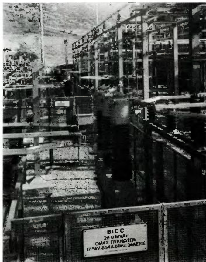
Τμήμα του υποσταθμού της Δ.Ε.Η.
