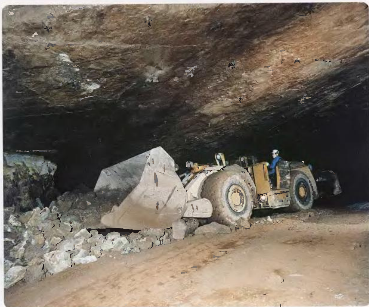
Φορτωτής υπόγειας εκμετάλλευσης βωξίτη.
