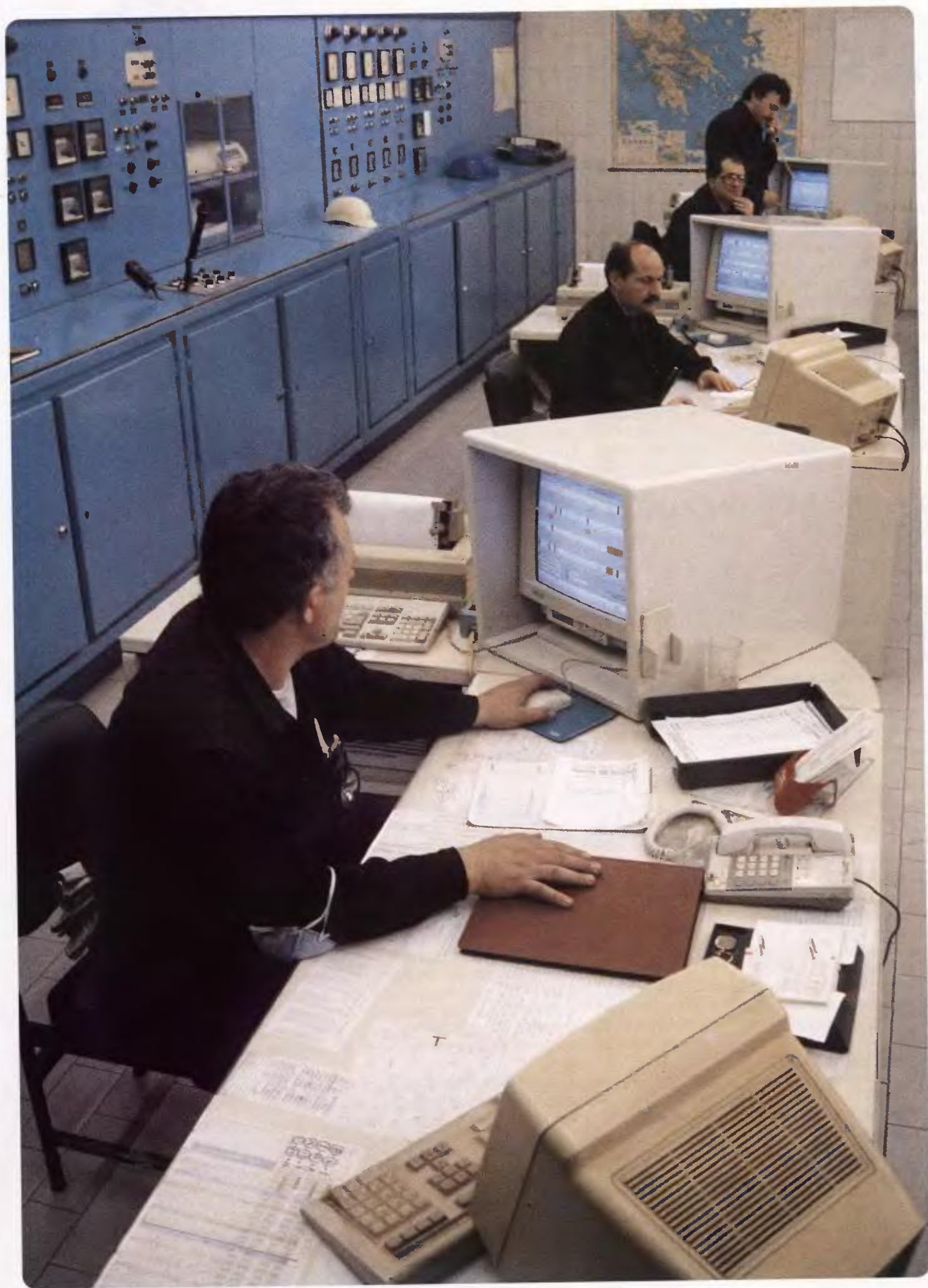
Η σύγχρονη αίθουσα ελέγχου των εγκαταστάσεων της Ηλεκτρόλυσης.
