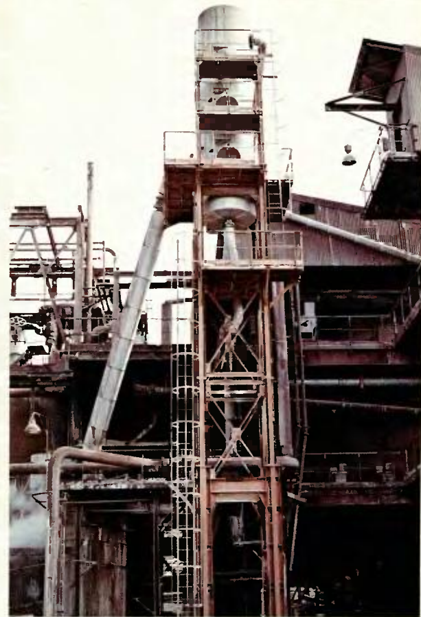
– Νέες εγκαταστάσεις εξοικονομήσεως ενέργειας Nouvelles installations d'économie d'énergie
