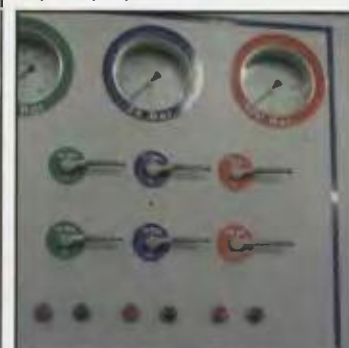
Πίνακας ελέγχου κυκλώματος αζώτου
