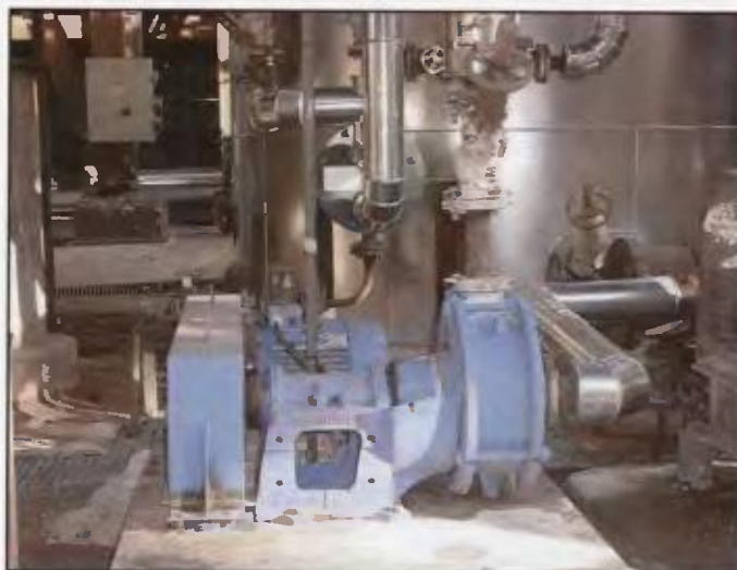
"Η αντλία κυκλοφορίας της σόδας προς τον εναπνέκτη"
