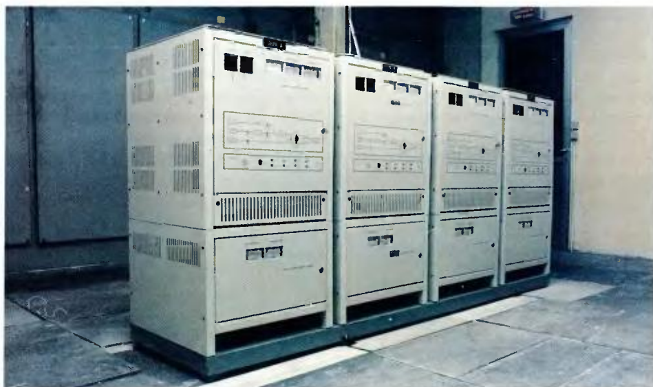
Τα τέσσερα UPS, ισχύος 3KVA το καθένα, που τροφοδοτούν τους υπολογιστές της Ηλεκ/λυσης στο DUPLEX.
